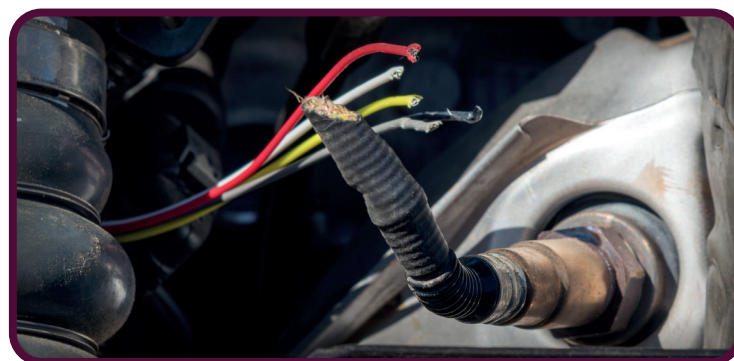
Marters hebben zeer scherpe tanden waardoor ze zonder problemen stroomkabels kapot bijten.
